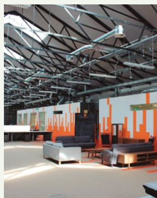
Zalando's løsning til dets lagerbygning konverteret til kontorer på Grand Canal Quay i Dublin. ECOi
